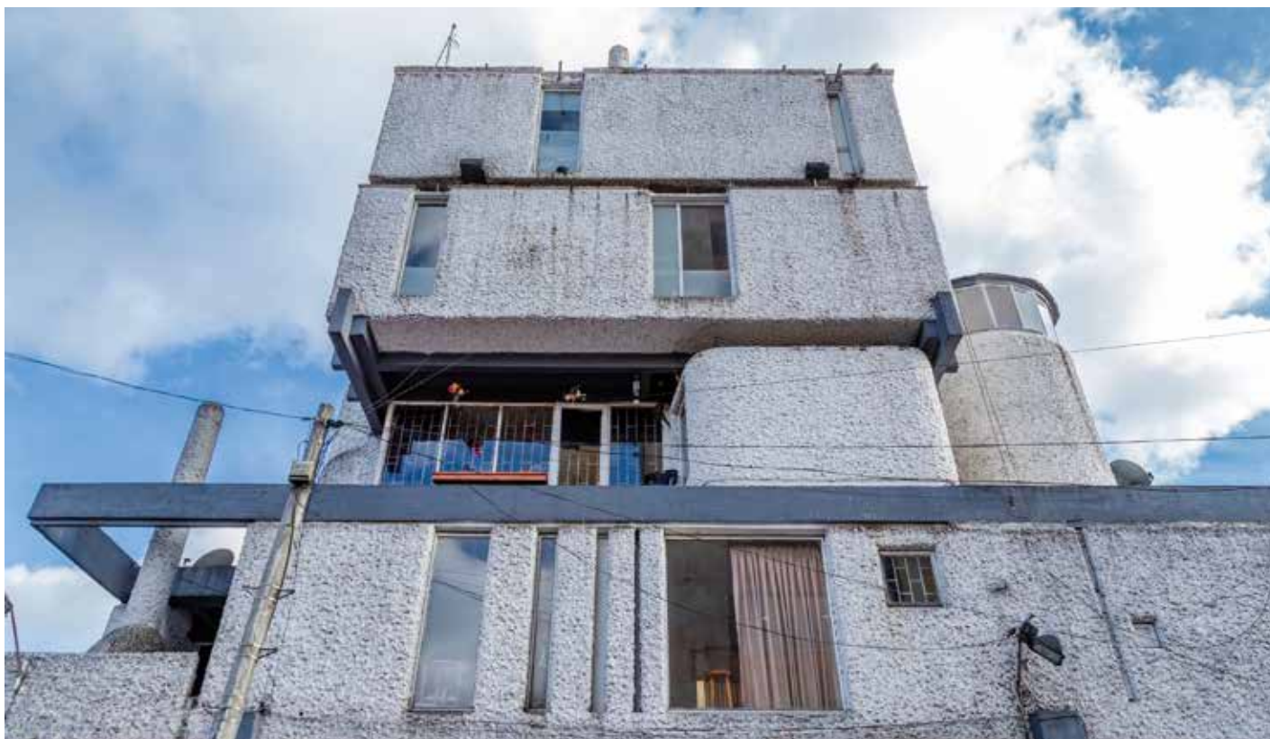
Detalle de la fachada con pañete blanco de textura rugosa y un tono azulado en la estructura de concreto a la vista. 2019. Fotografía: Carlos López - IDPC
