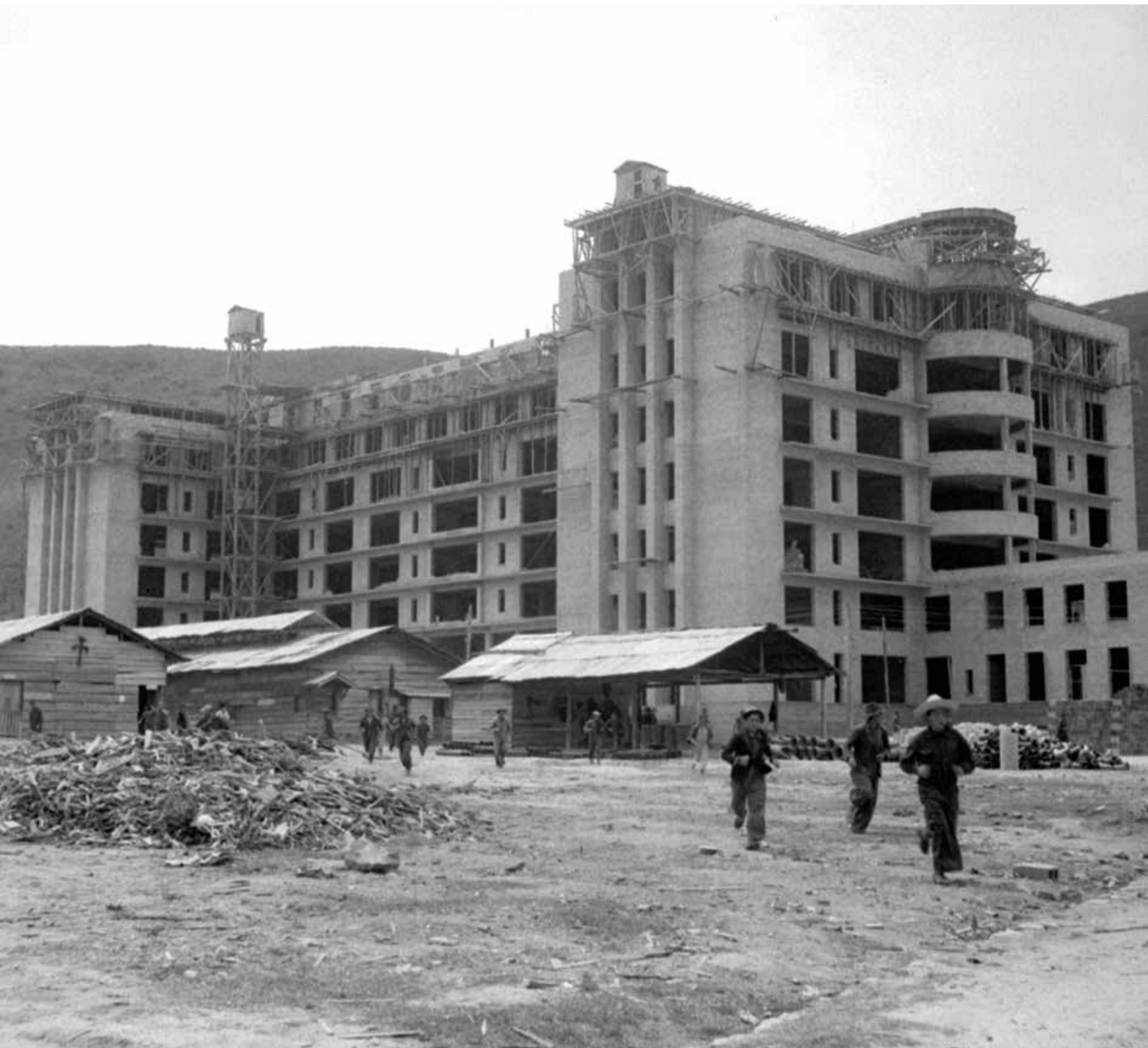
Vista del conjunto hospitalario en proceso constructivo. S. f. Fondo Daniel Rodríguez (MdB19008). Colección Museo de Bogotá
